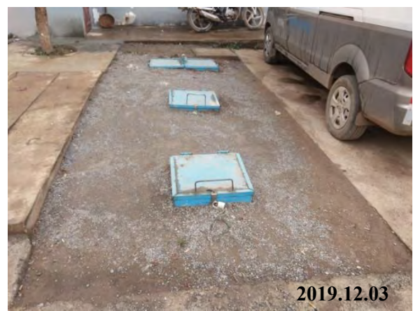
院内污水处理站
